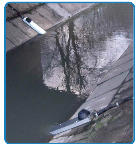
Wandlerhalterung auf Edelstahl-C-Profilen, hier: 2-Ebenenanlage
