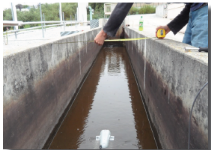
Beispiel einer SonTek-IQ-Installation im Kanal
